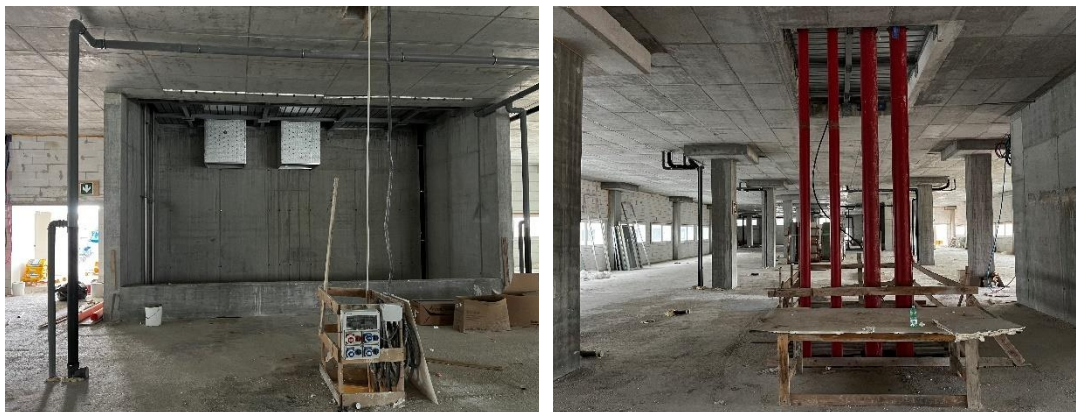
Predisposizioni impiantistiche già realizzate
