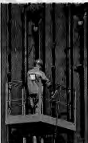
ILVA Fuga di gas alle cokerie
